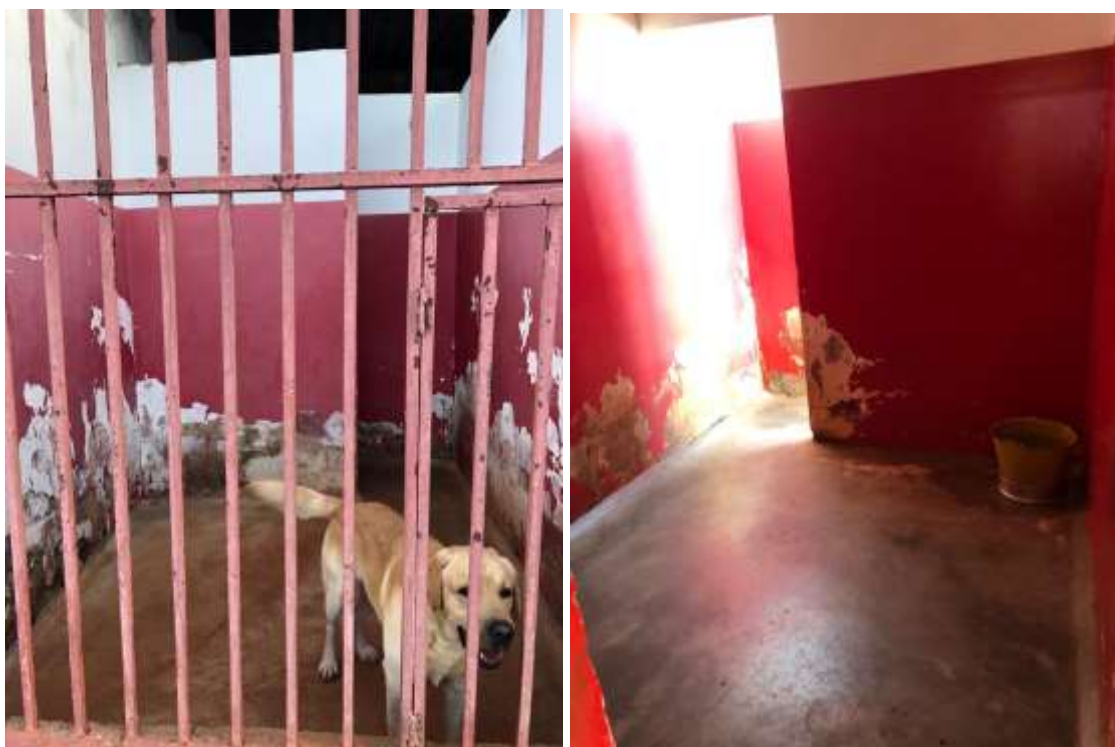
Figura 4 – Solário (à esquerda) e abrigo (à direita), das baias do canil do CBMDF.
