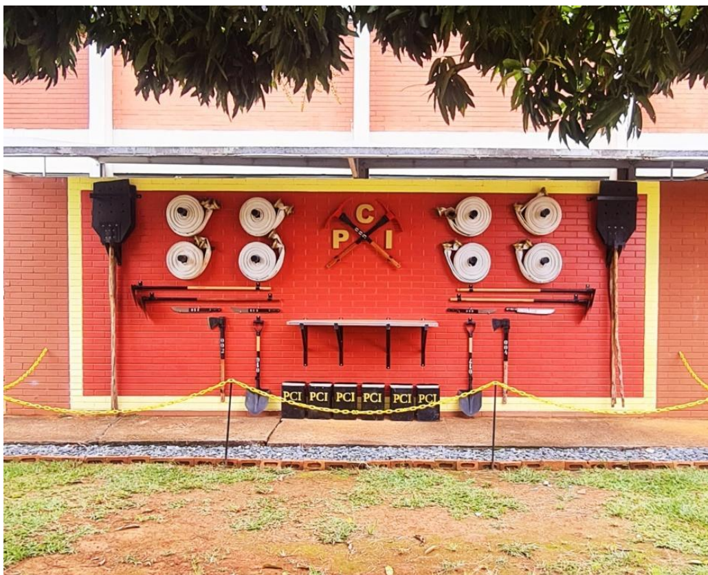
Figura 33 - CCOMGEX: Dispositivos de combate a incêndio
