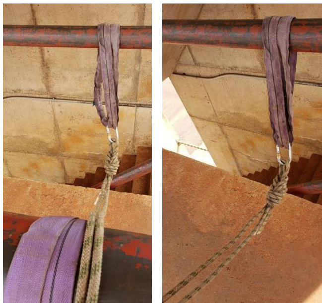
Figura 5 – Ancoragem secundária indireta na Torre Auxiliar
