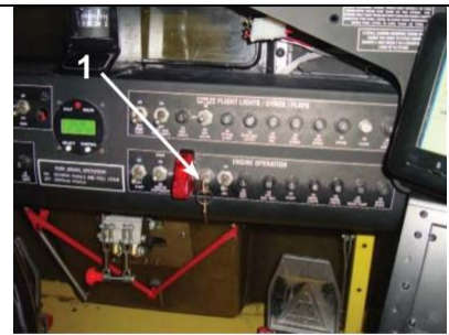
Corte de bateria
