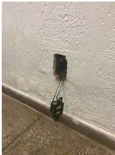
Figura 25 – Tomada elétrica com cabos expostos
