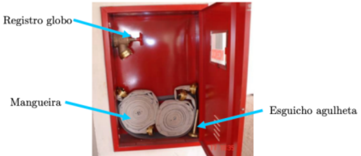
Figura 5 - Caixa de hidrante de parede e acessórios
