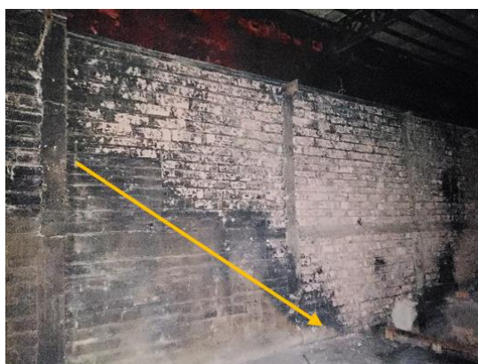
Figura 4-42 – Direção do dano mais severo na parede interna da pista de dança principal.
