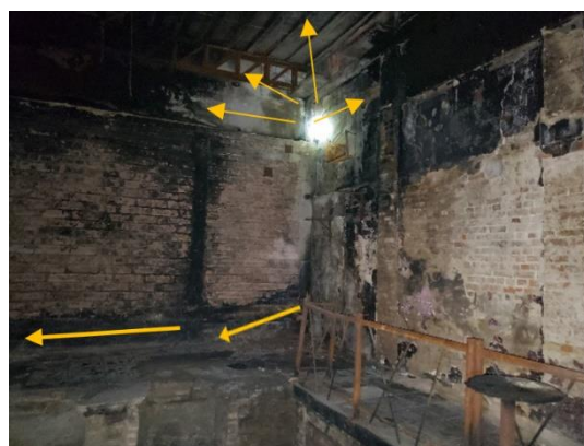
Figura 4-43 – Direção do dano mais severo na parede interna da pista de dança principal.
