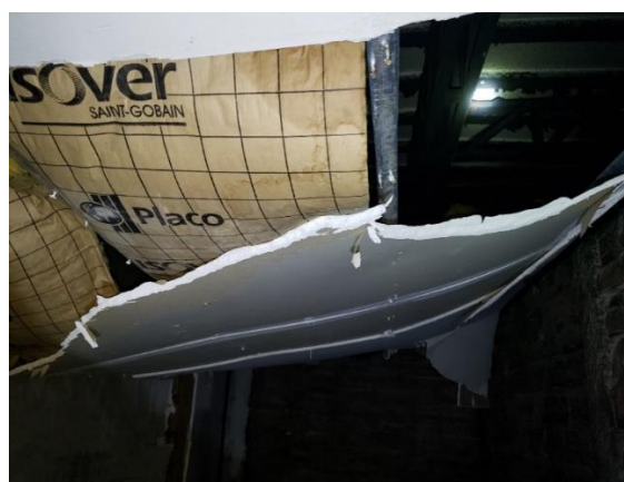
Figura 4-19 – Colapso das placas de gesso do teto.
