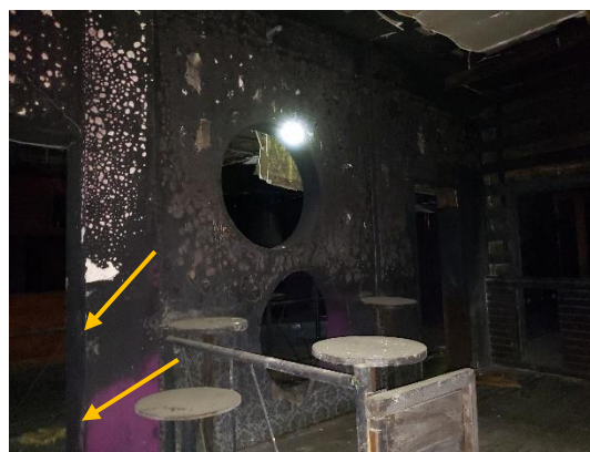
Figura 4-40 – Orientação e direção da degradação mais severa na parede interna da pista de dança principal.
