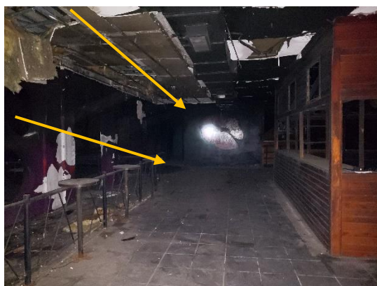
Figura 4-39 – Orientação e direção da degradação mais severa no corredor principal. Parte externa à pista de dança principal.
