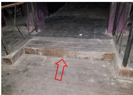
Figura 4-33 – Degrau singular existente em rota de fuga.
